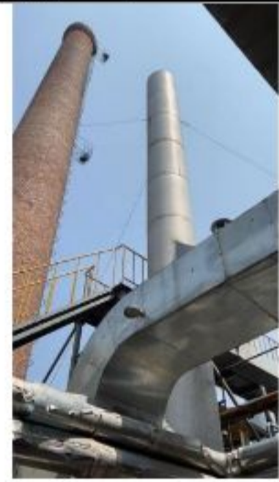
DA001、DA003废气排气筒
