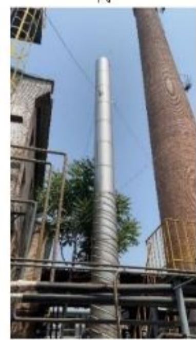
DA002废气排气筒
