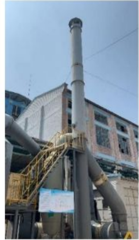
DA004废气排气筒
