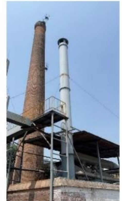
DA005废气排气筒
