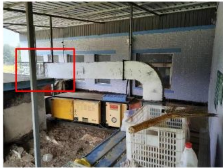
油烟净化器（红框内为排放口）
