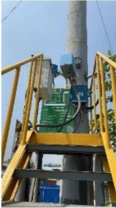
DA006废气排放口、监测口标识牌
