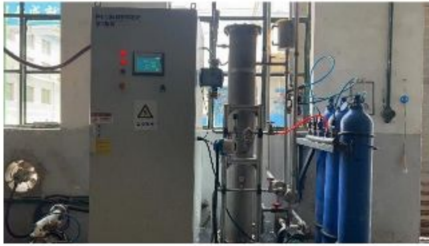
污水处理站内部
