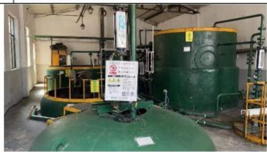
污水处理站内部
